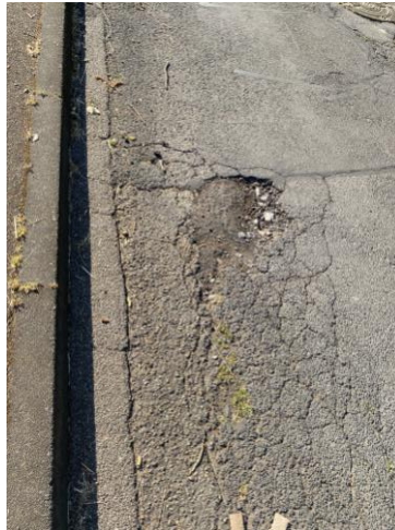
Straßenschäden Sonstige größer Asphaltausbrüche
