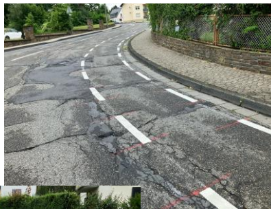
Massive Straßenschäden im Bereich der Kurve, verursacht durch hohe Lenkkräfte LKW
